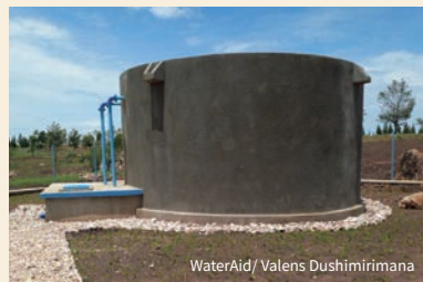
給水システムの貯水槽
