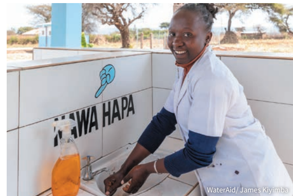
ヘルセンターに新設した手洗い設備を使う看護師(タンザニア)
